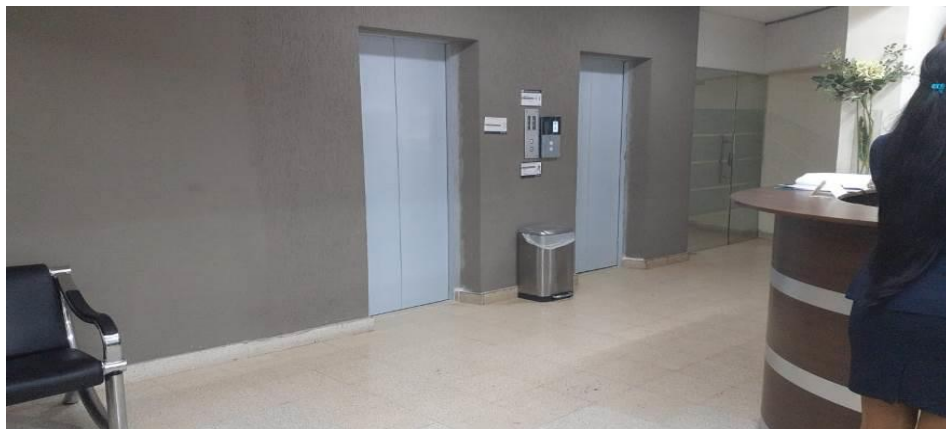
Fotos: Suministro e instalación de dos (2) elevadores de última tecnología en el edificio Gusromares. Efectuado por la empresa Hi Tech Equipments, S.A., a un costo de B/.256,607.22. Octubre de 2021.
